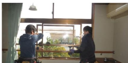
宿泊室の窓の開閉がスムーズになりました
